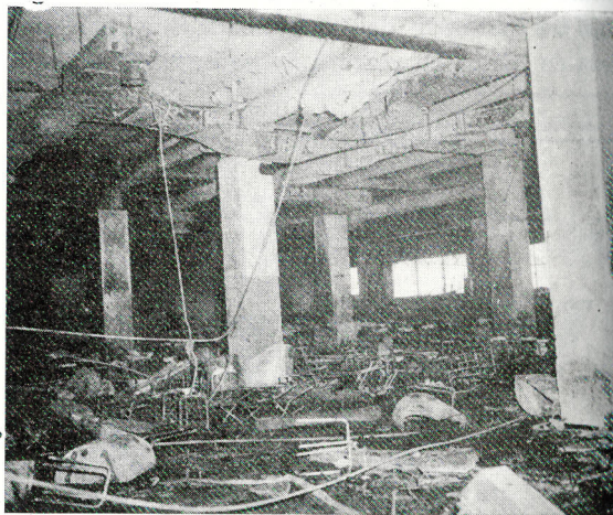
La sección del séptimo piso en la que se inició el fuego. Todas las materias combustibles quedaron reducidas a cenizas.
